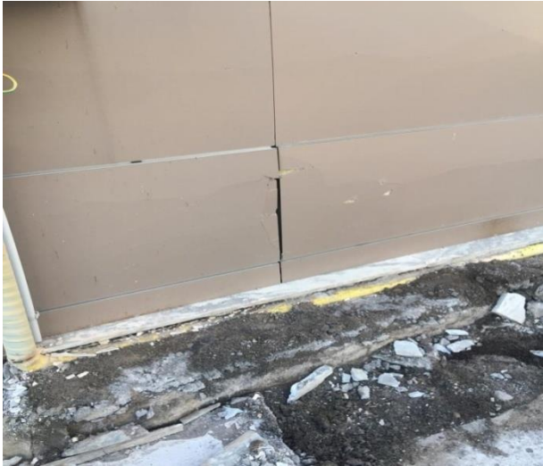
T2/7 Blok Dış Cephe Kaplamasına Verilen Zarar
